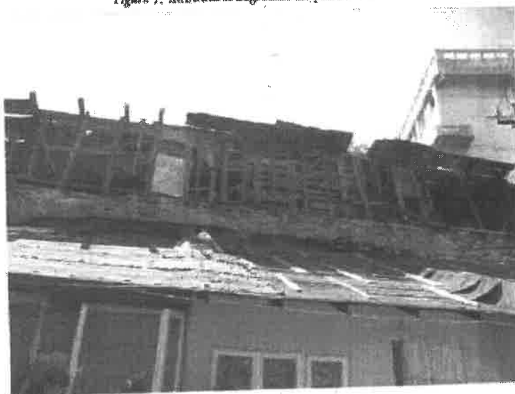
Figura 8. Elemente degradate la nivelul invelitorii
