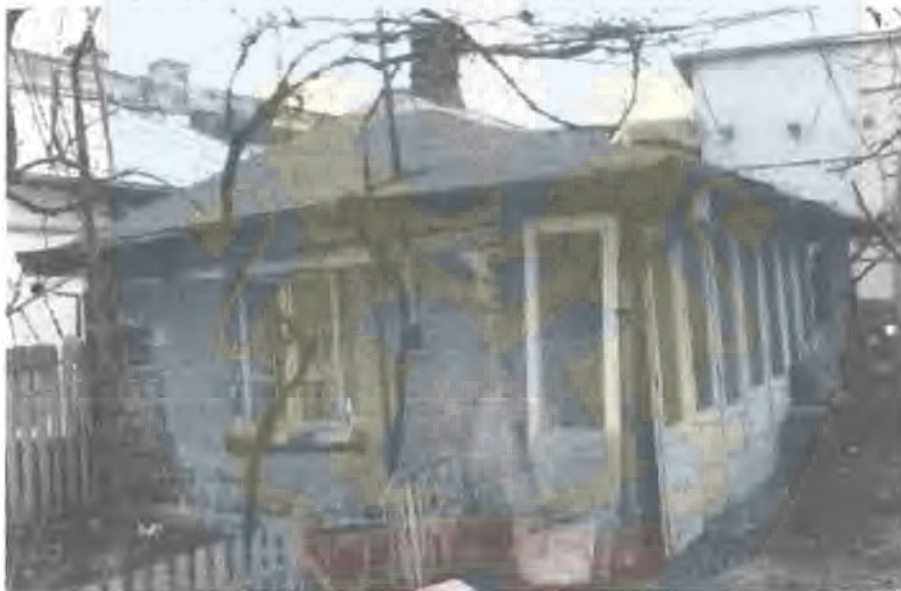
Foto 1. Starea cladirii parter din str. Boian nr. 3, Ploiesti, in data de 23.02. 2015. Anul prezent nelocuita de aproximativ 6 ani si debransata de la retelele stradale existente in zona.
