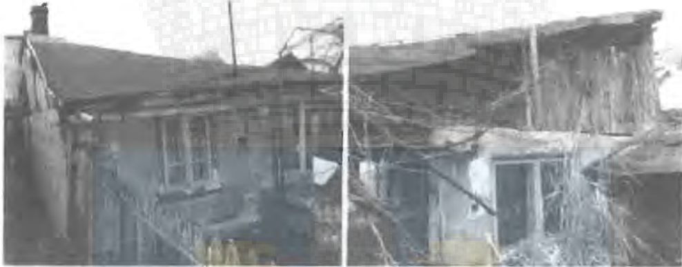
Foto 2, 3. La stanga fatada din strada, si calcan lateral stanga pe limita de proprietate. La dreapta fatada opusa strazii.
