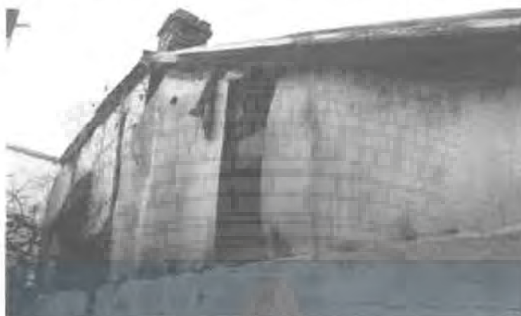
Foto 16, 17, 18. Aspect perete calcan lateral stanga la partea superioara.
