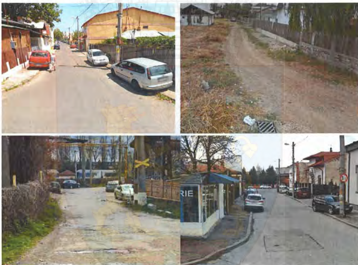
Figura 2.37. Străzi a căror suprafață de rulare se află în stare tehnică proastă (Exemplificare).
