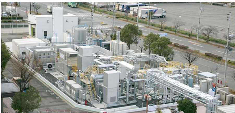
Figura 6.12 - Centrală de cogenerare urbană alimentată 100% cu hidrogen
