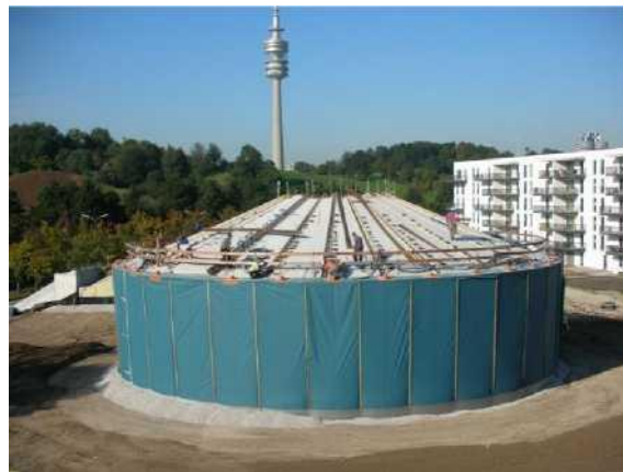
Figura 8.11 - Rezervor de stocare sezonieră a căldurii cu volumul de 5700 m 3 de apă construit din elemente prefabricate de beton în Munich (Germania) (cf. cu Pauschinger et. al., 2018)
