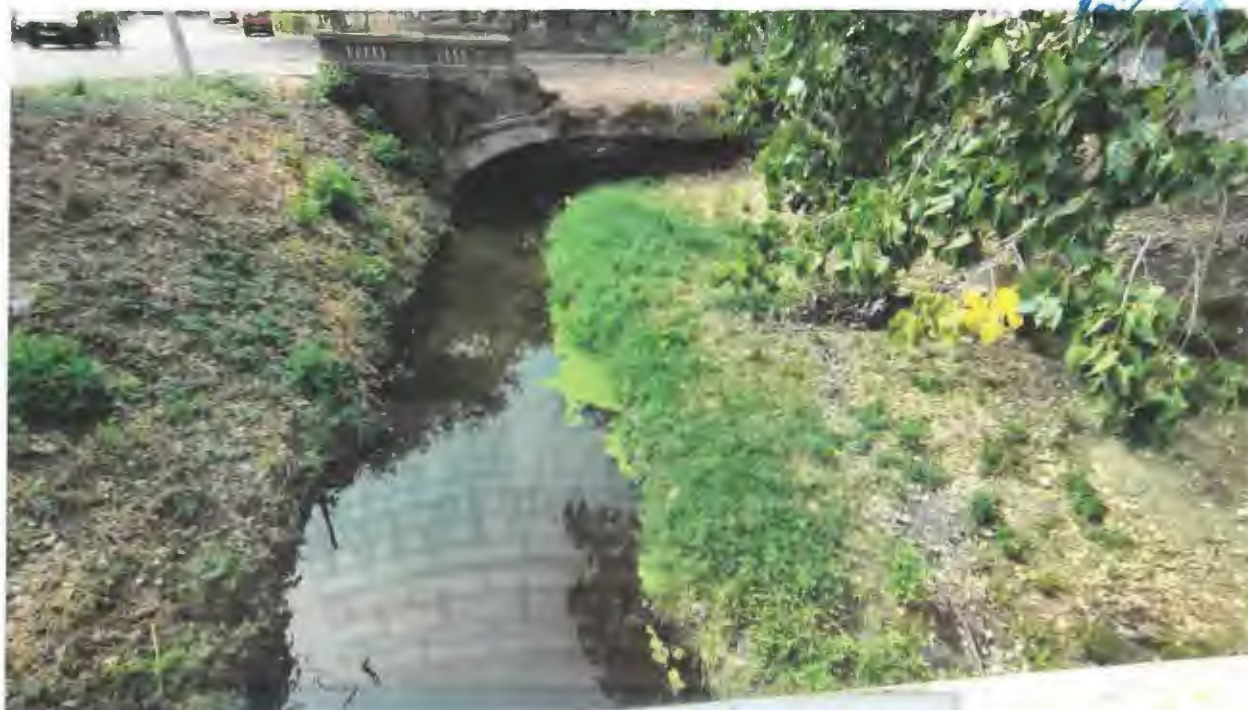
Foto 26: Vedere albie in amonte, depuneri, vegetatie si colmatare
