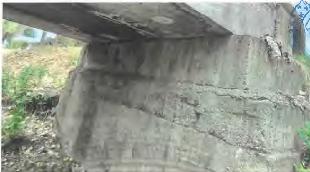
Vedere culee mal stang
