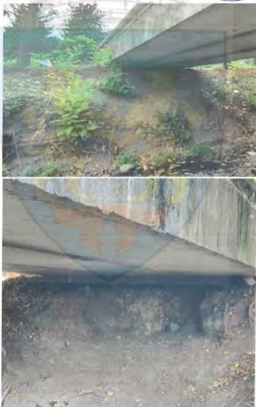
Vedere culee mal drept
