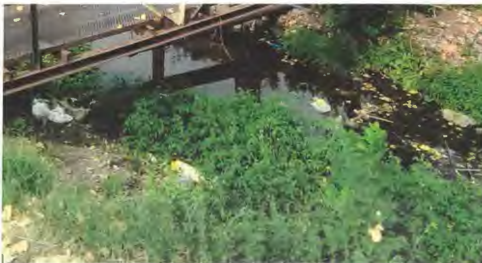
Foto 19: Vedere albie sub pasarela, depuneri, vegetatie
