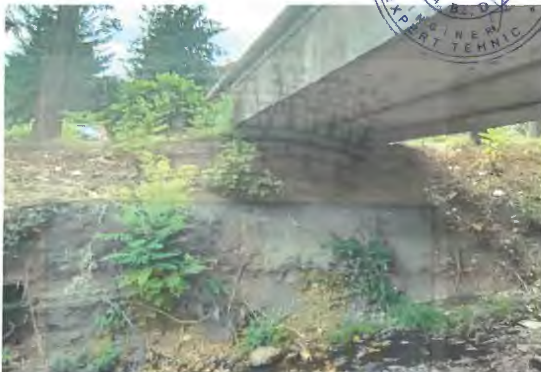
Vedere culee mal drept
