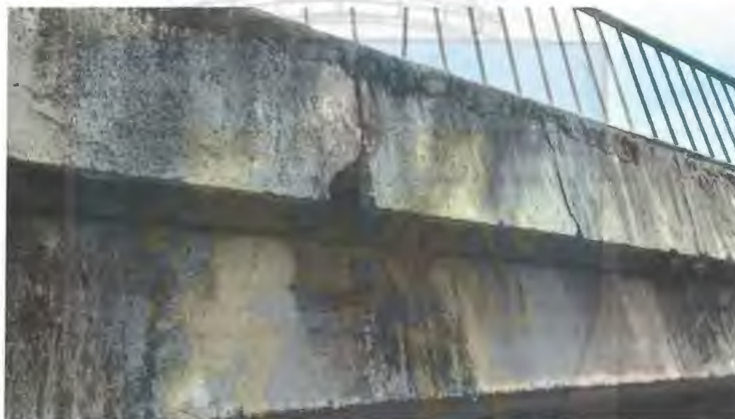
Foto 13,14: Degradari consola de trotuar si lise de parapet
