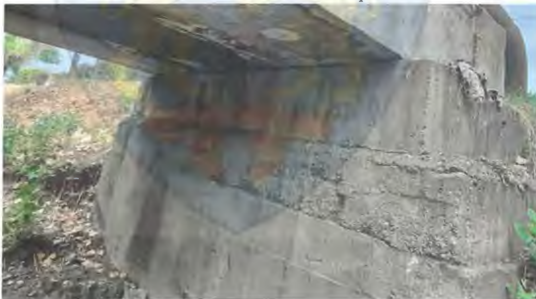
Vedere culee mal stang
